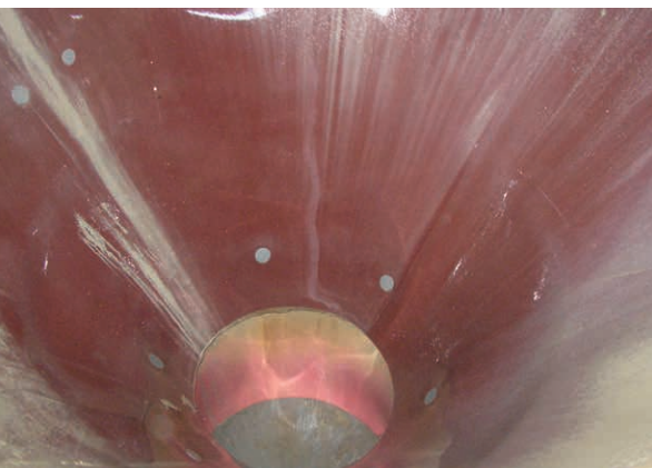
Verschleißbeständige Auskleidung eines konischen Zuführtrichters in der Schüttgutindustrie.
